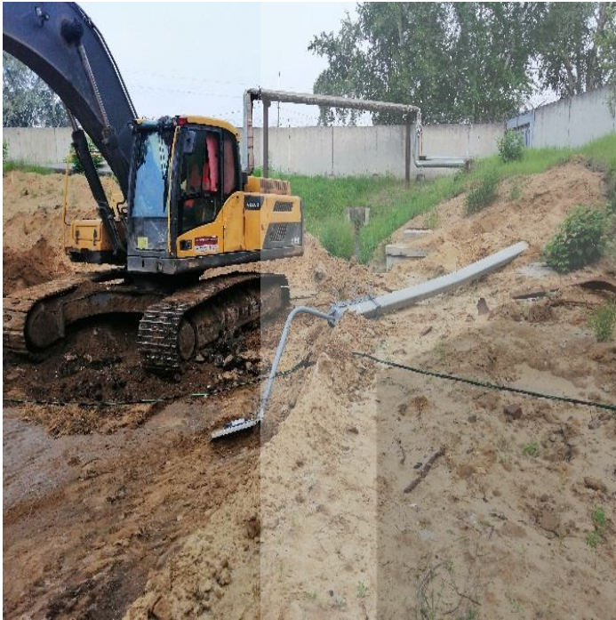
Повреждение спецтехникой ЛЭП и опоры уличного освещения
